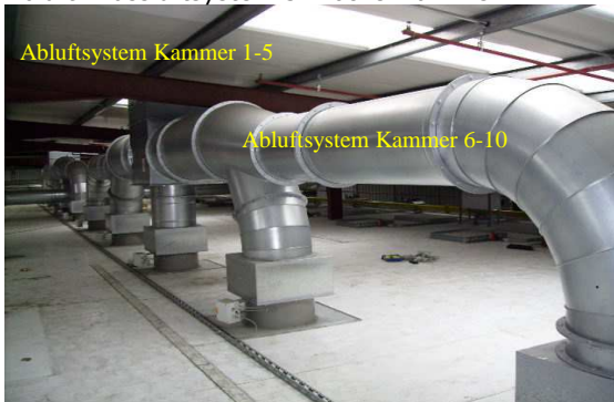
Abluft- Nassluftsystem 2x5 Trockenkammern
