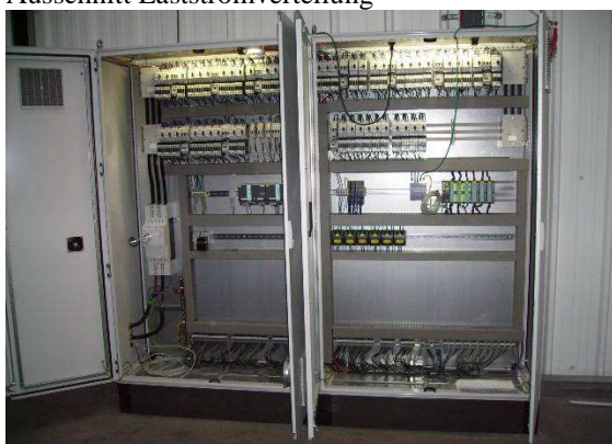
Steuerschrankfeld 1+2 Haupt- und Laststrom /SPS
