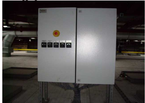
SPS Verteilerschrank 5 Kammern mit Profibus
