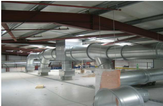
Abluft- Nassluftsystem 5 Trockenkammern
