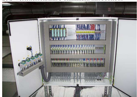
SPS Verteilerschrank 5 Kammern mit Profibus
