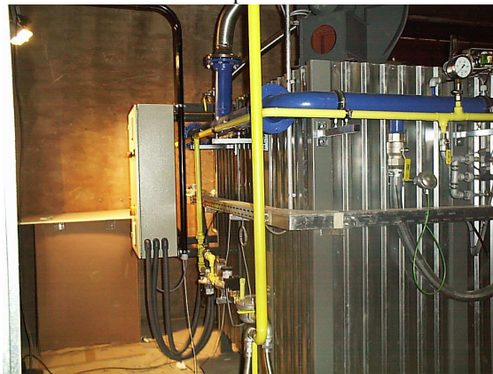
Seitenansicht mit zentral angebrachter MSR- Steuerung und Medienverteilung Gas und Verbrennungsluft.
