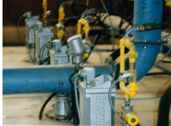
HG - Deckenbrenngruppe 8 Zündbrenner je 85 kW Flammenleistung im BBM- Impulsbetrieb 0-450 Imp. unterhalb der Zündtemperatur. [HEGWEIN BR1-Brenner]
