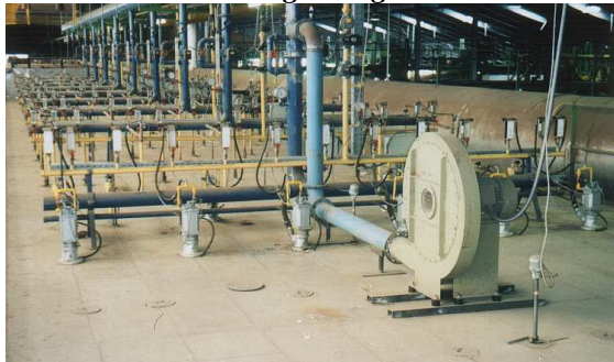
HG-Zündbrennergruppe mit zentraler Verbrennungslufterzeugung im Impulsbetrieb (Brenngasstrahlmodulation) 0-450 Imp./min.
