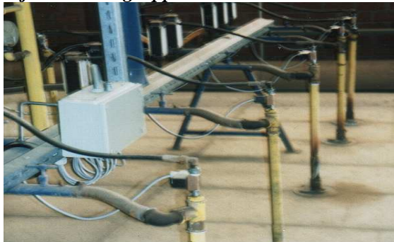
Injektorbrennerlanzen mit Impulsperipherie und elektrischer Anbindung.
