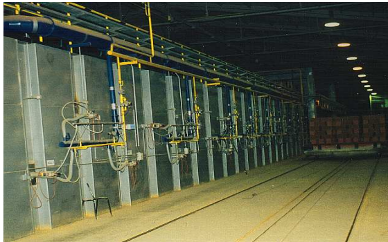
Bild 2: Peripherieaufbau mit Medienverteilersystemen linke Tunnelofenseite.
