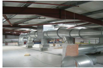
Bild 18.2 Abluftsammlersystem zur Überdachabführung der Nassluft von 5 Kammersystemen mit Abluftventilator je Kammer und Sammelabluftventilator für Abluftsystem 5 Doppelkammern.
