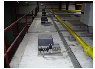
Bild 18.3 Brennaggregateaufbau an Einfahrseite spiegelsymmetrisch mit Ausfahrseite. 20 Gebläse-brennaggregate mit je max. 400 kW Flammenleistung.
